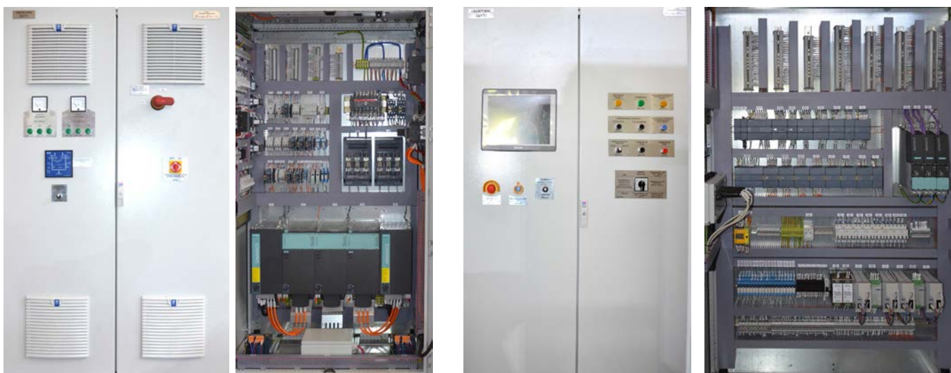
Шкафы микропроцессорного контроллера управления конвейером пассажирским
