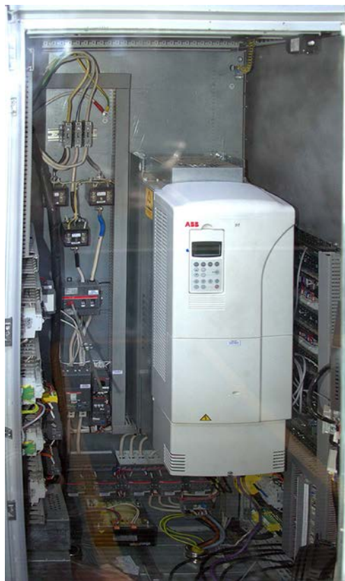
Шкаф управления эскалатором
